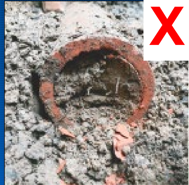
Drain de fondation obstrué
